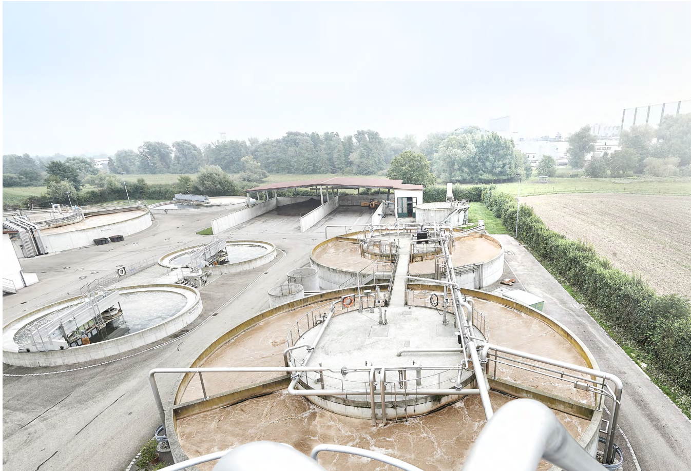
Установка для очистки сточных вод молокоперерабатывающего предприятия.
